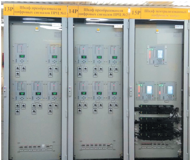
Рис. 8. Общий вид оборудования второго (общеподстанционного) уровня системы цифровых защит с централизованным резервированием на ПС
