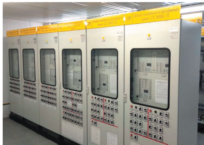
Рис. 7. Фотография оборудования первого уровня системы защиты для сегментов ПС стороны 35 кВ
